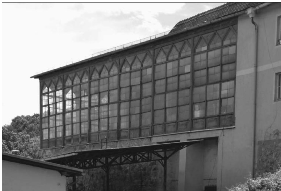
Der „Glaspalast“ – Sommerkeller in der Innenstadt – ein Sorgenkind der Denkmalpflege. (Zieske)
