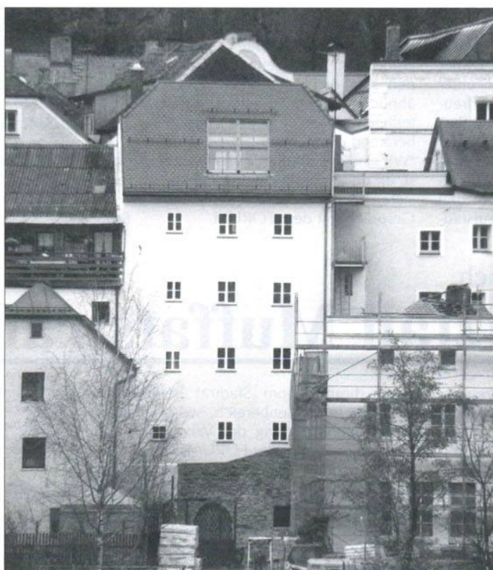
Ein Riesenloch im Dachstuhl: Wieder einmal wurde ein Präzedenzfall geschaffen, der hoffentlich keine Nachahmer findet.
